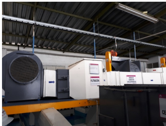
FOTOGRAFÍA 2. SISTEMA DE FILTRACION
